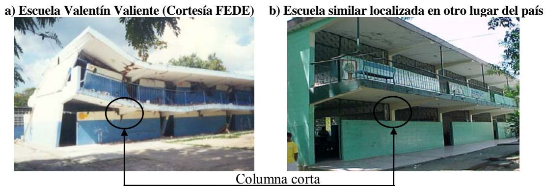
Figura 2.5. Los dos edificios de la escuela Valentín Valiente derrumbados en el sismo de Cariaco de 1.997 son del Tipo Antiguo I que se encuentra en muchos otros lugares del país.
