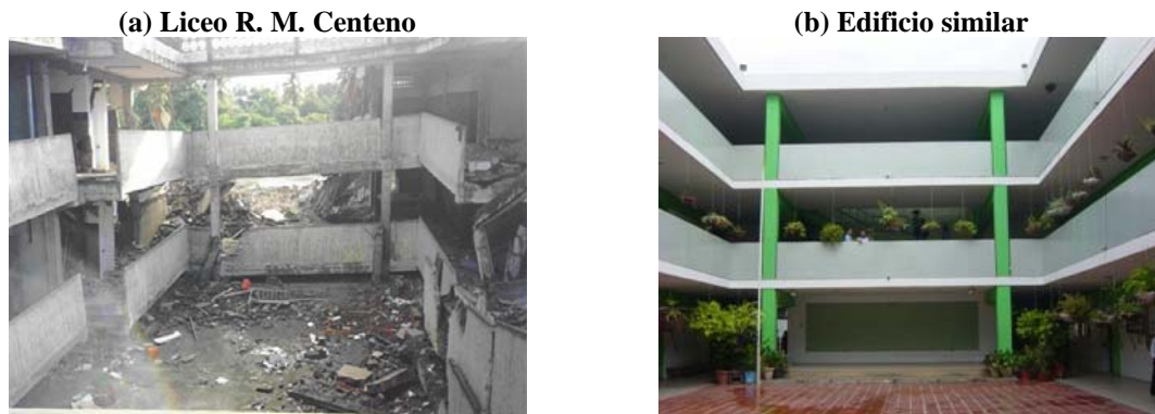
Figura 2.6. Los dos edificios del Liceo R. M. Centeno derrumbados en Cariaco en 1.997 pertenecen al Tipo Cajetón que se encuentran distribuidos en todo el país.
